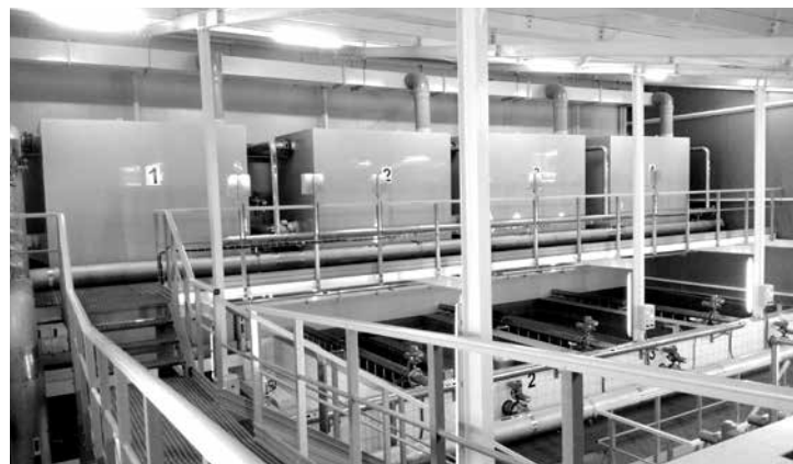
Úpravna vody Zaječí technologie
